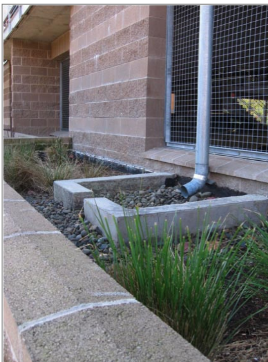
Gouttière déconnectée dirigée vers une plate-bande, Portland. Photo : N. Bédard
